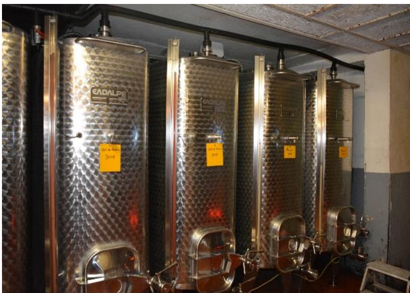
Quellenabsaugung von CO 2 mit Abführung ins Freie
