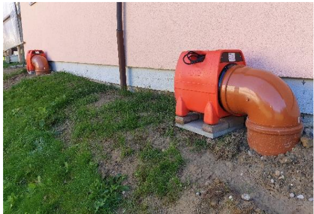
Zwangsbelüftung mit Ventilatoren (Leistung: 3'000m 3 /h). Ein Ventilator saugt die CO 2 -reiche Raumluft ab, der andere bläst frische Luft ein.
